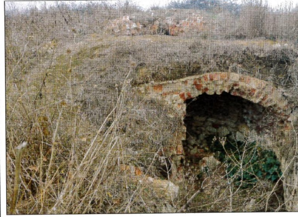
Tabyanın kaçak kazı ile tahrip edilen tuğla örgülü kemerli girişi.
